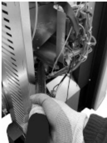
Fig. 58 - Room fan cleaning
