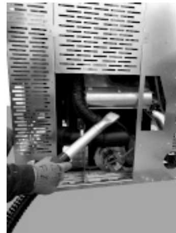
Fig. 59 - Room fan cleaning
