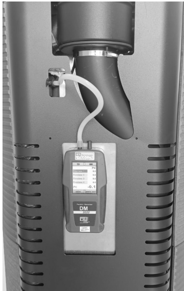
Fig. 38 - Conexión del presostato digital
