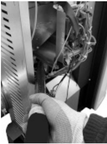
Fig. 60 - Limpieza ventilador ambiente
