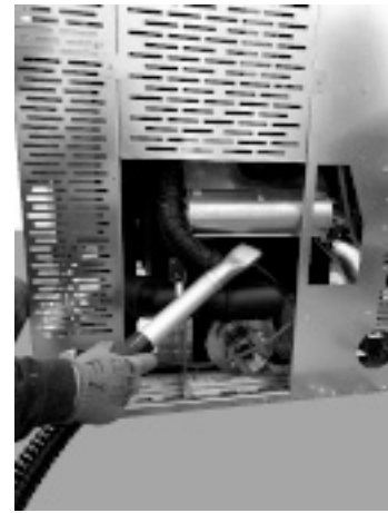
Fig. 61 - Limpieza ventilador ambiente
